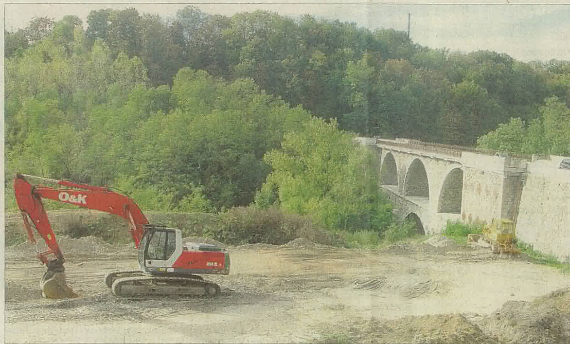
Aux Moulins, le remblai en activité sur la commune d'Arthaz, a créé un véritable trou dans la forêt. Le risque est réel pour les riverains de la Menoge. Un constat alarmant également : 70 % des zones humides du département, ont disparu sous les déblais du BTP. Le D/L/S/Pe
